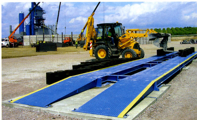
Niskoprofilowa waga najazdowa Mars-ST w firmie Skanska
